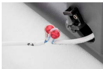
Aansluitingen buiten het frame
