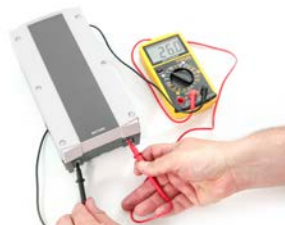
Überprüfung der Spannung der Batterie
